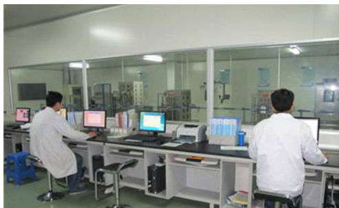
总控室 Master control room
